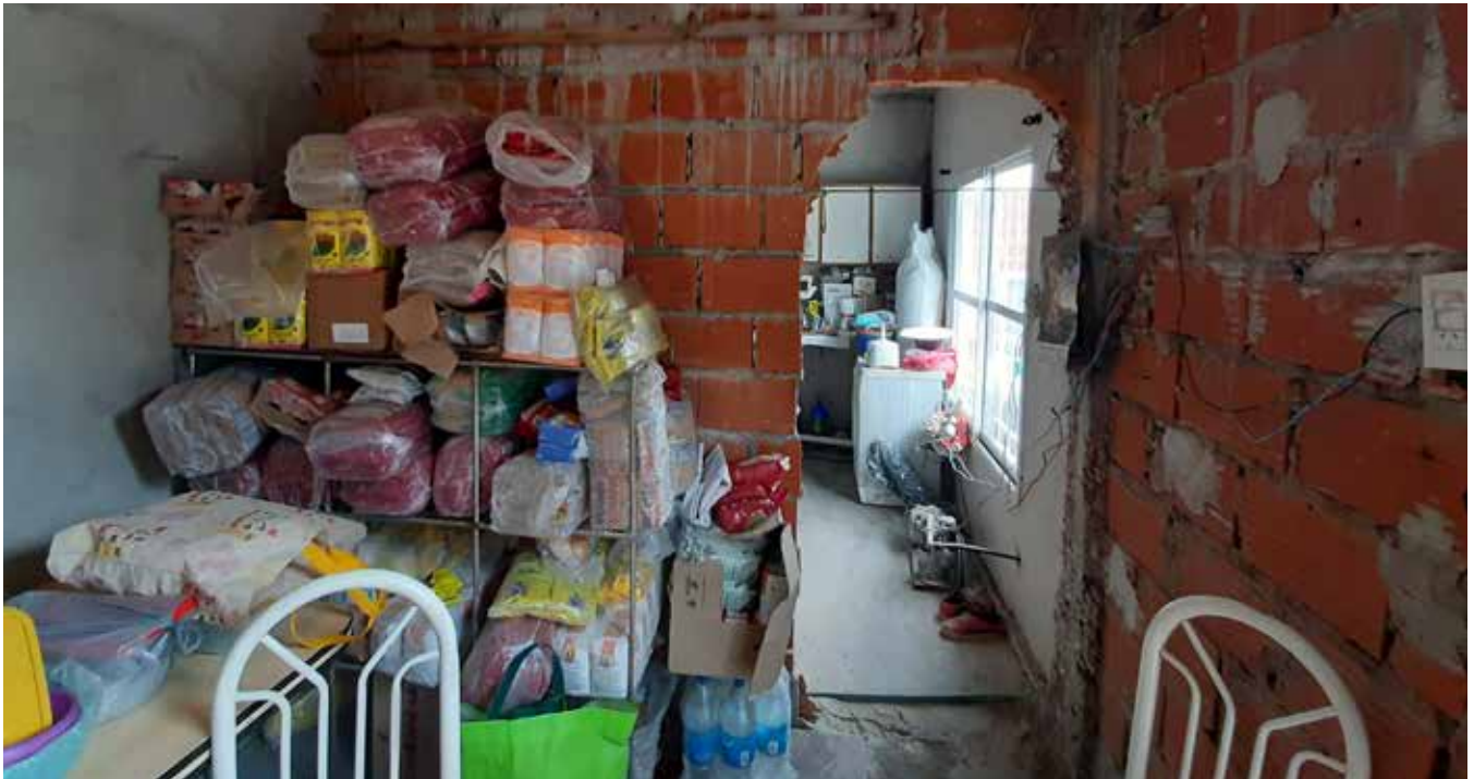
Barrio 23 de Diciembre, Moreno. Los impactos de la falta de proyecto son poco visibilizados y dimensionados y en muchos casos implican deficiencias estructurales de la vivienda difíciles de corregir o modificaciones funcionales que implican demoliciones y reconstrucciones.
